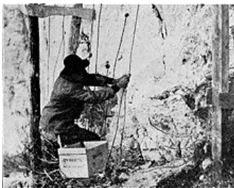
Le chargement à la dynamite des trous de mine et la pose des cordons détonants.
