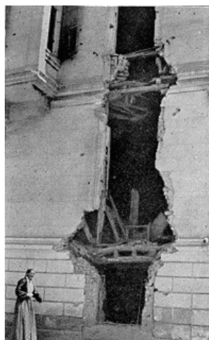
Brèche ouverte dans la maison du général Hessaptchef, qui, parti la veille, y avait laissé un poste bulgare.
