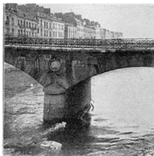
Le pont, interdit à la circulation, quelques minutes avant l'accident: de profondes fissures sont visibles, à droite et à gauche de la pile.--Phot. Girard.
